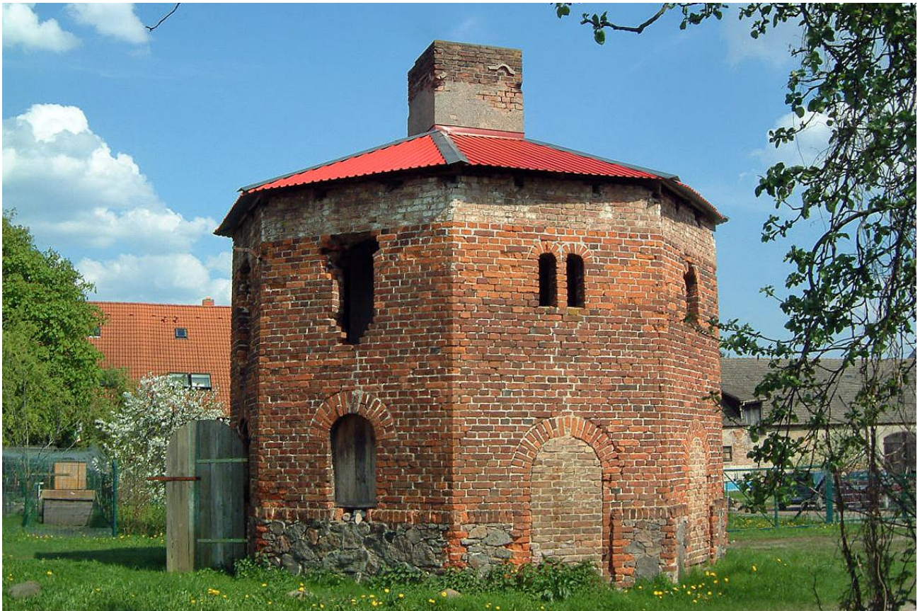
4.05.2006 Westseite der Backhausruine, gut erkennbar die Noteindeckung mit Blechplatten.
