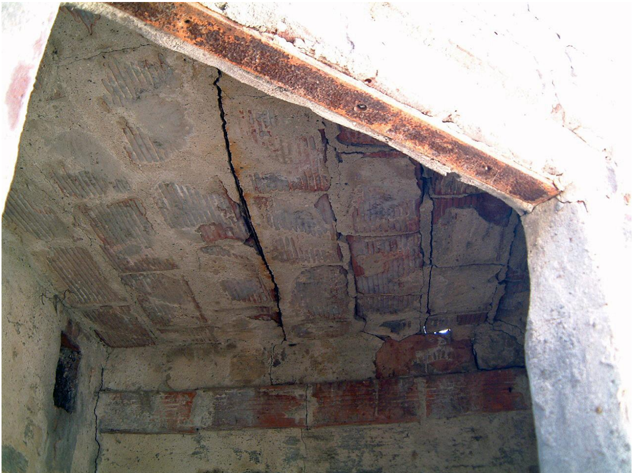
Risse in der Deckenkonstruktion einer Räucherammer im Obergeschoss.
