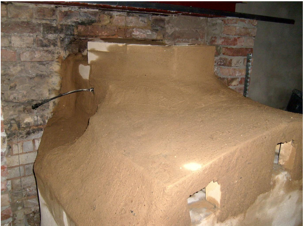
Der neu aus Schamottesteinen gemauerte Ofen von der Rückseite. Bilder Petra Gentes
