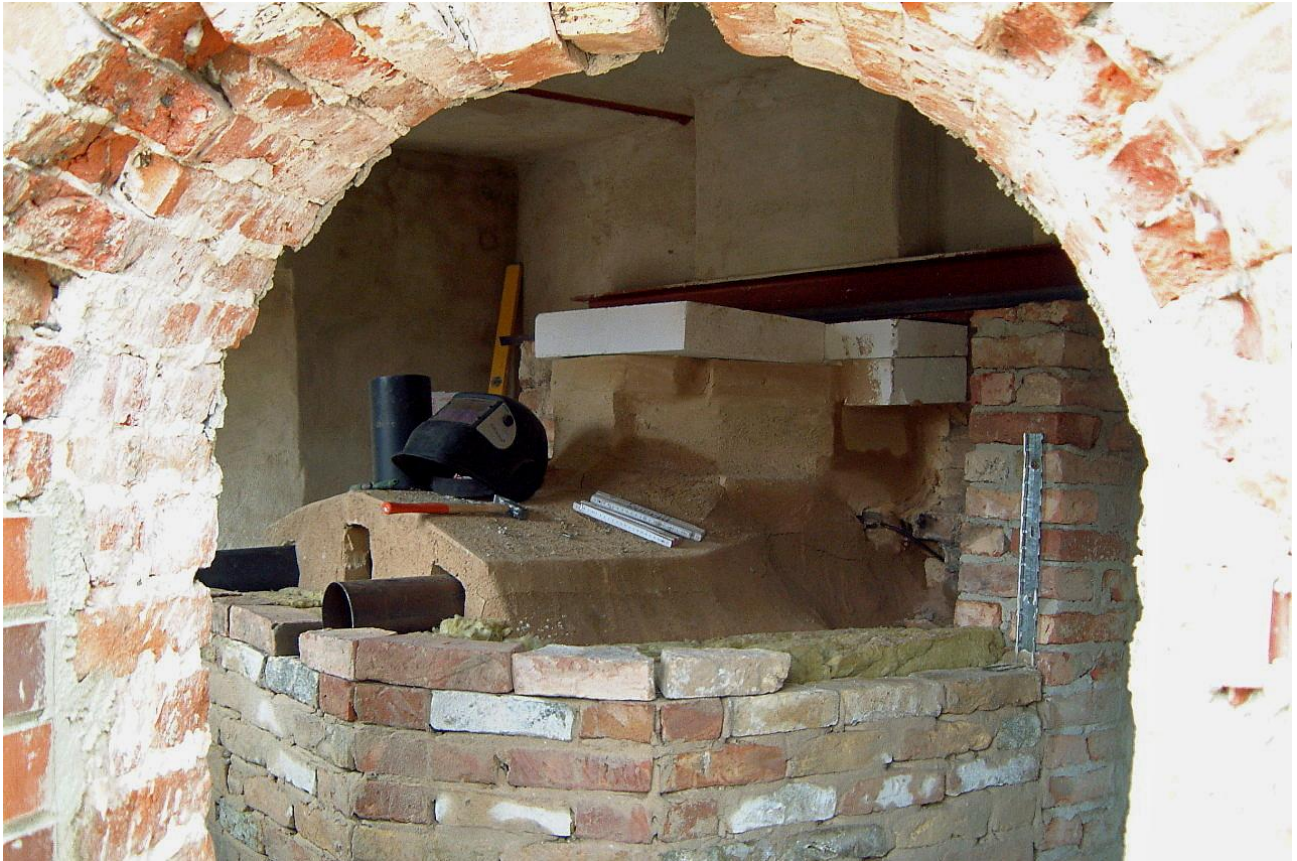
Ofen innen Schamottesteine, eine Isolierung und Außenwand Klinker. Bild Dipl. Ing. Rolf Kammel
