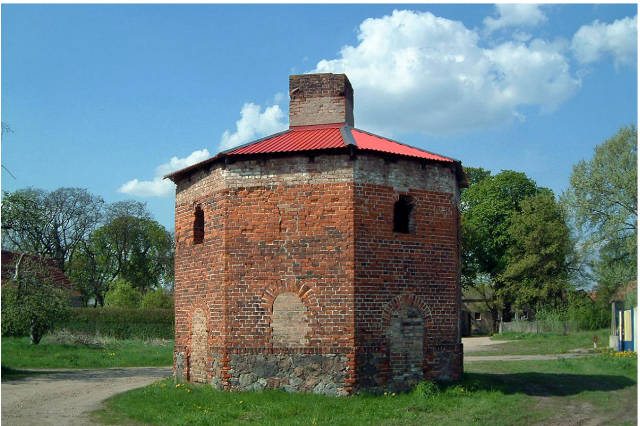
4.05.2006 Südseite der Backhausruine mit den in den 1930er Jahren zugemauerten Fenster und Türen. Bilder Dipl. Ing. Rolf Kammel
